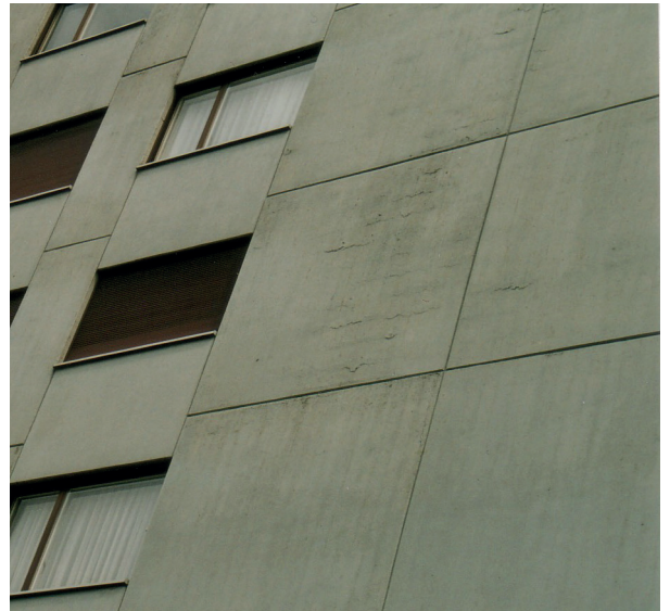
Enrobage insuffisant généralisé
