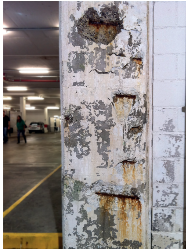
Korrosion infolge Karbonatisierung des Betons
