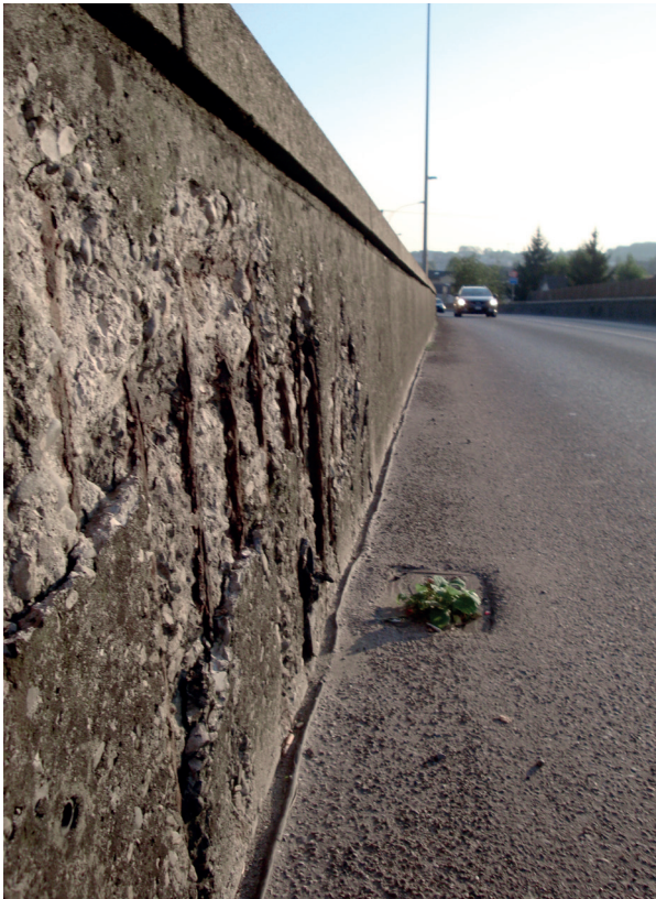
Korrosion infolge Chlorideinwirkung
