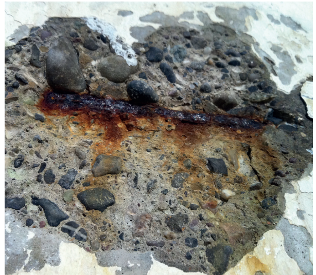
Betonabplatzung infolge Bewehrungskorrosion
