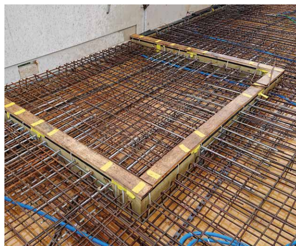
Ci-dessus : Des consoles ACINOXplus® raccordent les loggias
