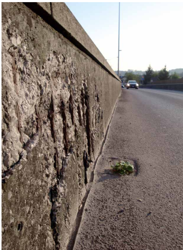
Corrosion due à l'action des chlorures
