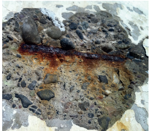
Betonabplatzung infolge Bewehrungskorrosion
