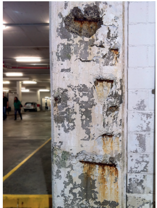
Korrosion infolge Karbonatisierung des Betons
