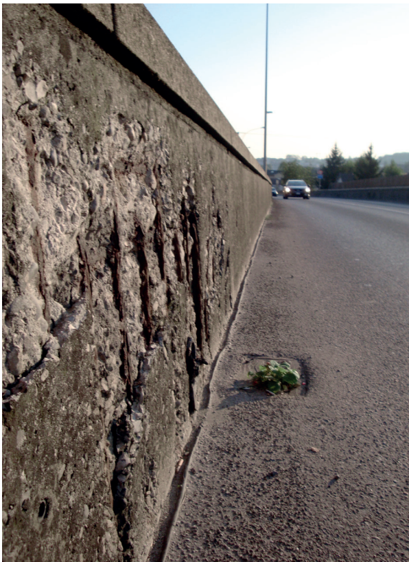
Korrosion infolge Chlorideinwirkung
