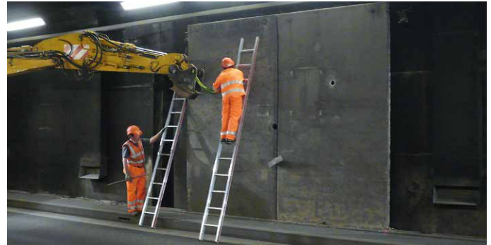
Demontage der schadhaften Platten. Diese können infolge der porösen Oberfläche nicht mehr mit dem Vakuumgreifer gehalten werden.
