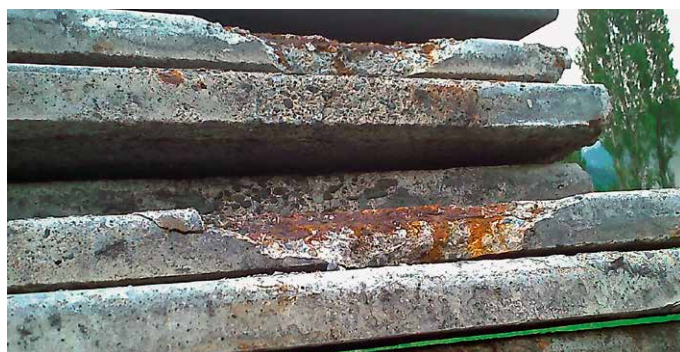
Schadhafte Wandplatten infolge Bewehrungskorrosion und Betonabplatzungen.
