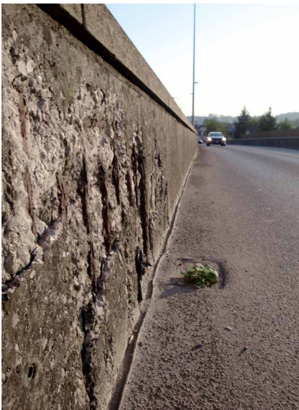
Corrosion due à l'action des chlorures
